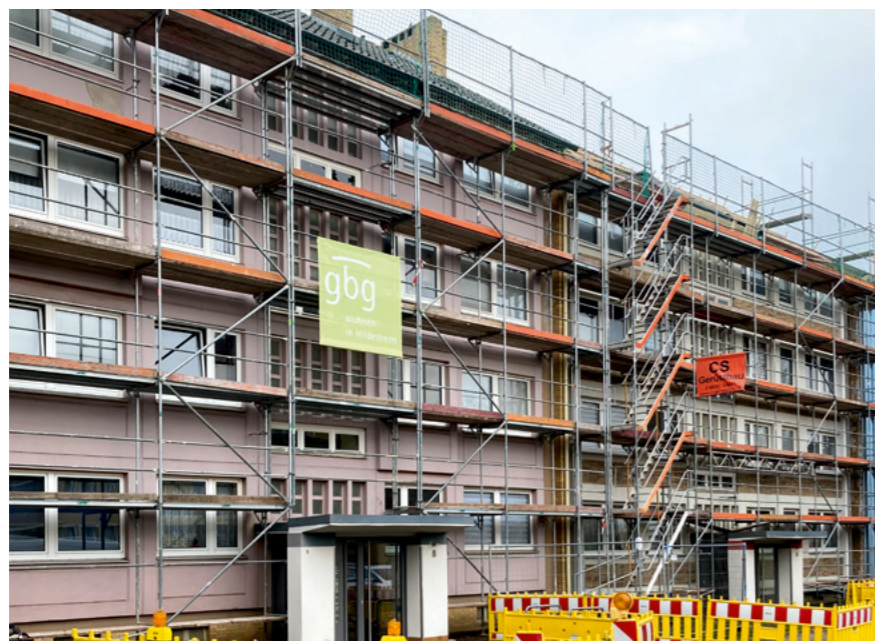
Straßenzug Doebnerstraße. Derzeit werden die Gebäude 6 und 8 energetisch saniert. Schritt für Schritt folgen weitere Häuser.
