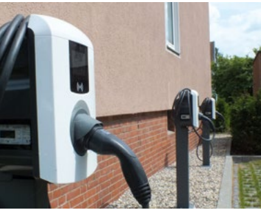
Neue E-Ladestationen am Moritzberg
